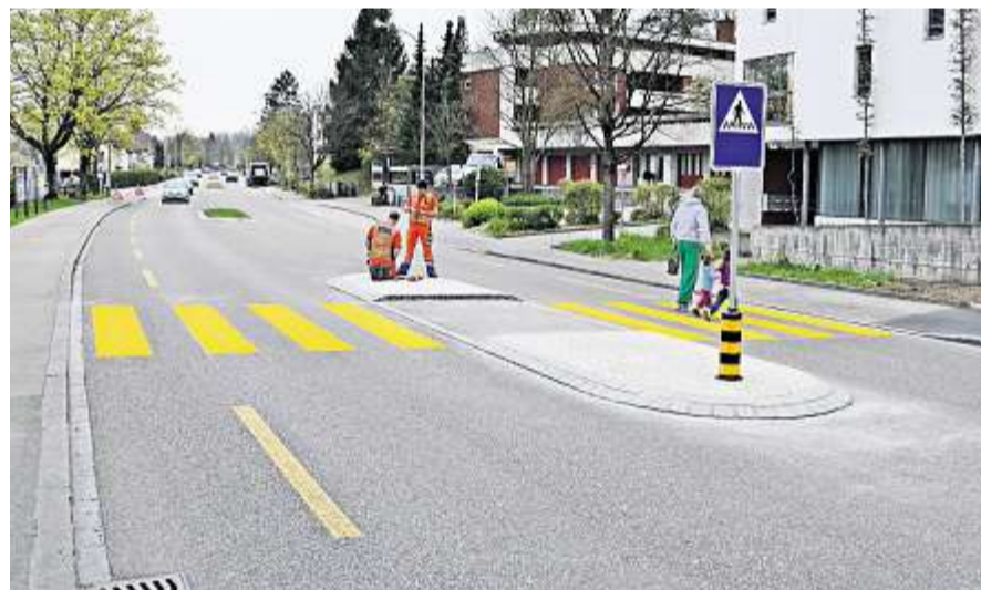
Auf dieser Strasse in Opfikon wurden mit der Strassensanierung des Kantons alle Fussgängerstreifen aufgehoben. Jetzt, drei Jahre später, ist plötzlich wieder einer da. Bild: cwü
